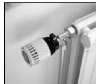
Thermostatventile vollständig öffnen.
