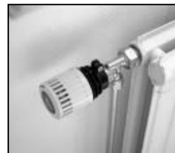
Thermostatventile vollständig öffnen.
